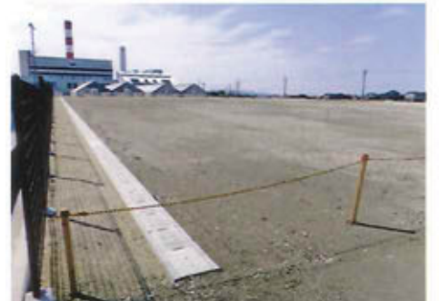
▲西区役所の西側に建設される西部交流センター。土地の整備も終了した。
