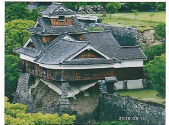
熊本城の崩壊した石垣と櫓
